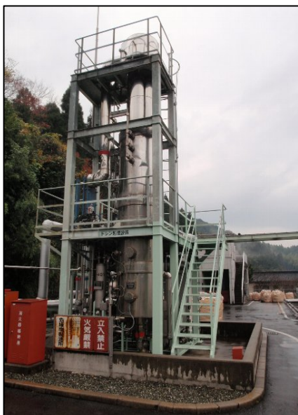
アルコール抽出凝縮ドレイン
